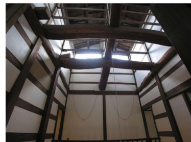
吹抜の高窓(開閉装置付き)
